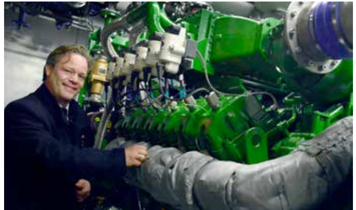
Johannes Einig, Geschäftsführer der AHE, am neuen Blockheizkraftwerk an der Biogasanlage in Witten. Foto: Barbara Zabka
