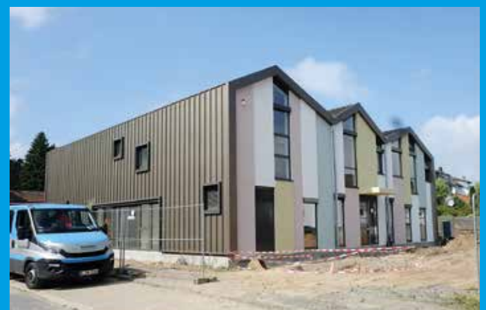
Bald können die Kinder in der Filiale Kita Fischerstraße in Gerthe einziehen. Der Neubau hat die Stadt Bochum mehrere Millionen Euro gekostet und steht an der Ecke Kircharpener Straße.
