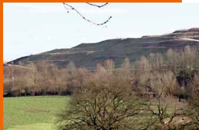
Die Zentraldeponie Kornharpen aus Blickrichtung Grüner Weg: Die noch erkennbaren Stufen an der nordöstlichen Seite der Deponie werden in den nächsten Wochen angeglichen. Es entsteht eine einheitlich geneigte Fläche. Foto: USB
