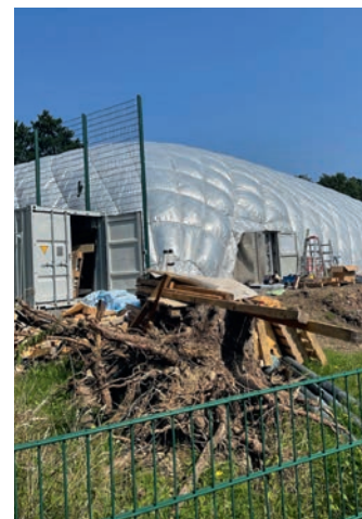
Die Sturzbäche haben der Traglufthalle nichts anhaben können. Die Handwerker bestätigen, dass die Halle das Unwetter gut überstanden hat.
